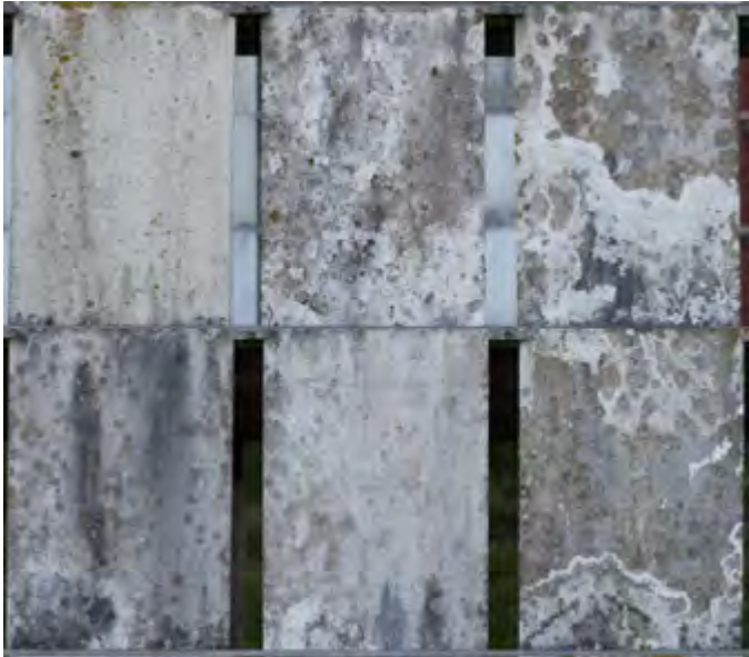
Abb. 24: Mikrobieller Befall von Fassadenfarben
