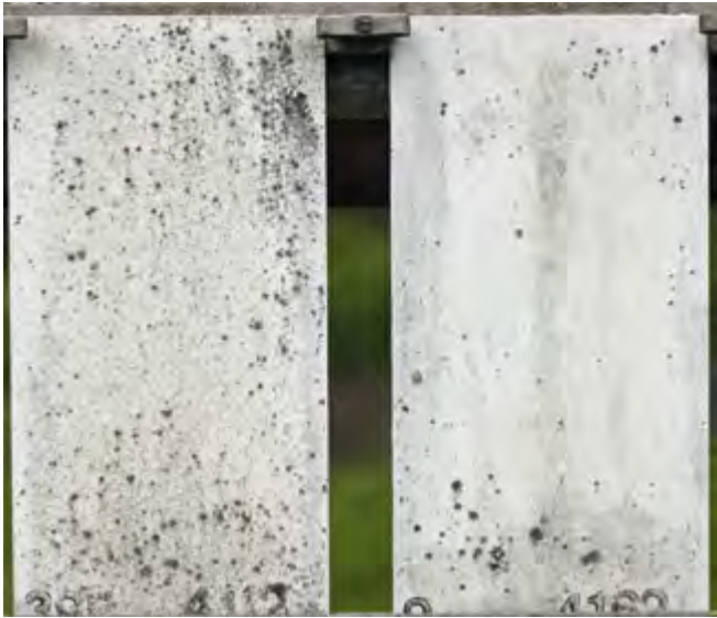
Abb. 27: Die gestrichene Fassadenfarbe (rechts) zeigt einen geringeren Pilzbefall als die gerollte (links)
